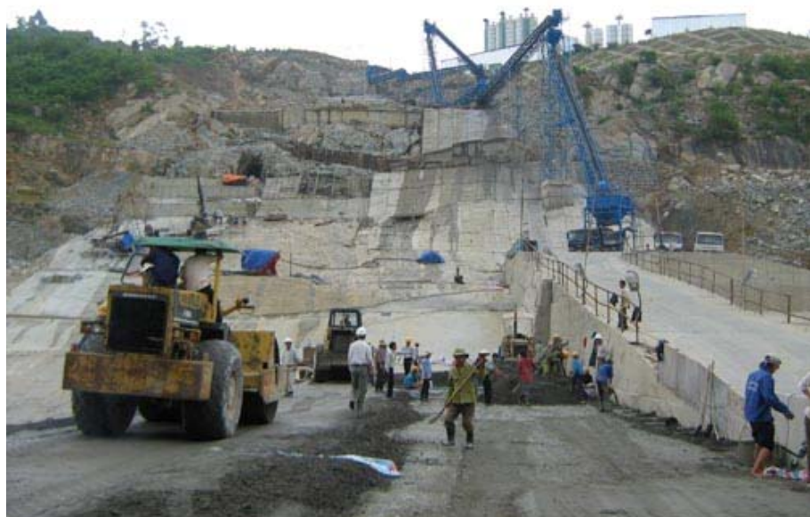
Công trình thủy điện Sông Tranh 2
