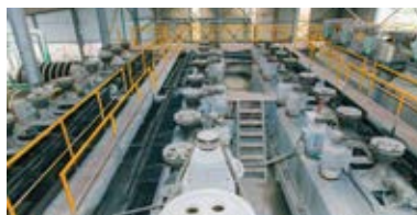
Hệ thống tuyển tro bay
